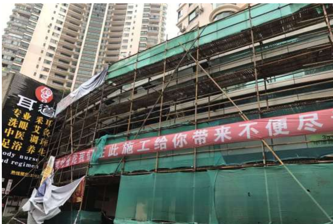
二、 被破坏建筑外墙照片
