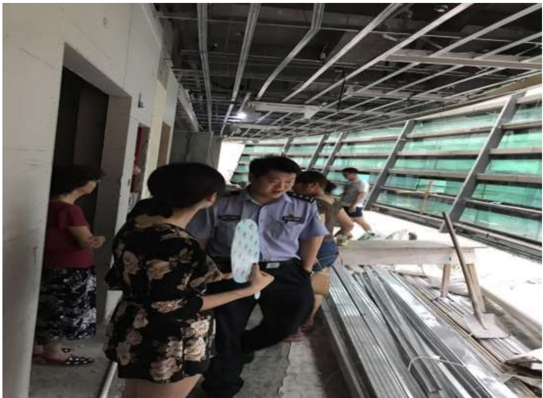
五、警务人员 8/4, 7 二天, 110 出警, 警告施工单位立即停工照片
